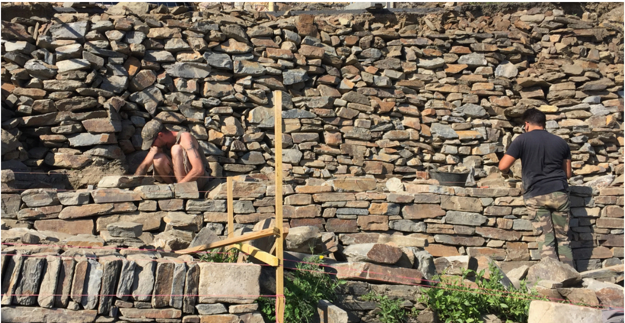
Réalisation par l'équipe de Pierre en paysage d'un mur de soutènement routier à Collioure, en 2018.
